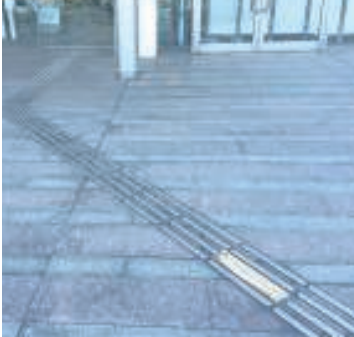
改善が望まれる点字ブロック(市役所入口)
